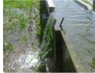
水路からの部分的な溢水
