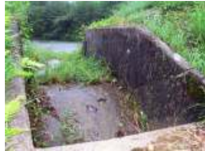
老朽化した洪水吐
