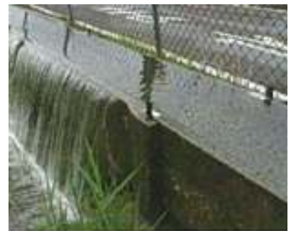
水路からの溢水
