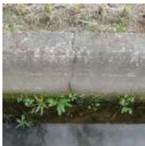
縦方向のひび割れ
