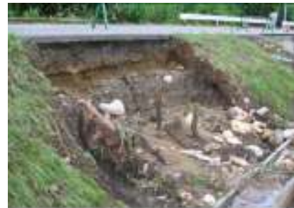
道路法面の崩壊
