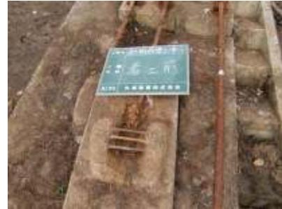
ため池における 老朽化したゲート
