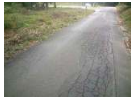
アスファルト舗装の老朽化
