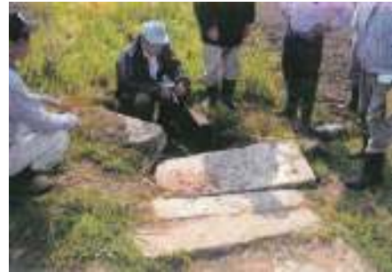
側溝蓋の損傷
