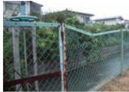
破損した金網フェンス
