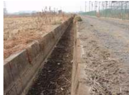
安全施設がない水路
