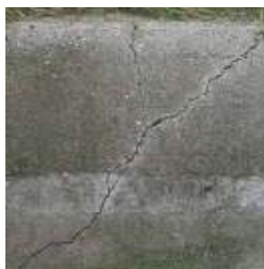
斜め方向のひび割れ
