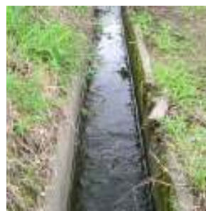
部分的な欠損
