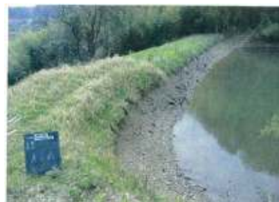
漏水が生じているため池
