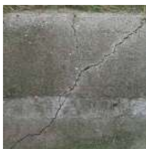
斜め方向のひび割れ
