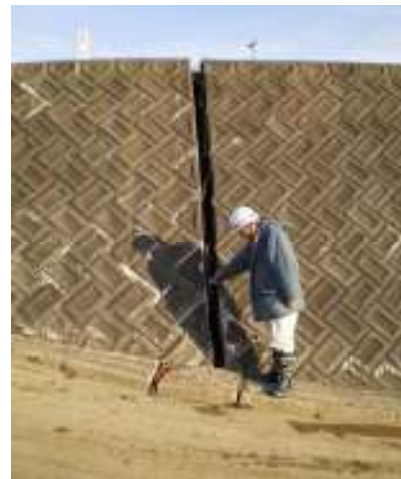
ブロック積みの隙間
