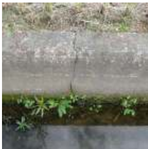
縦方向のひび割れ
