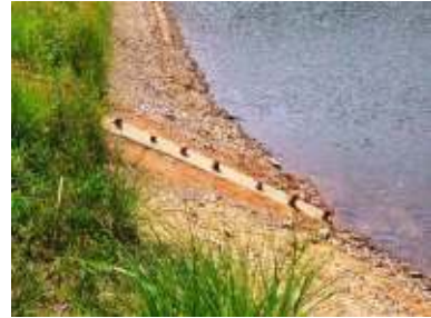
老朽化した取水施設
