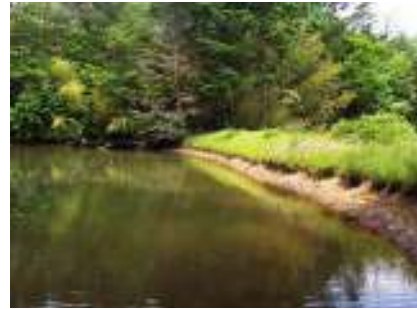
堤体が洗掘されているため池
