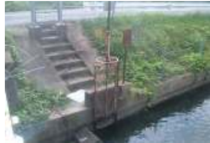
老朽化したゲート
